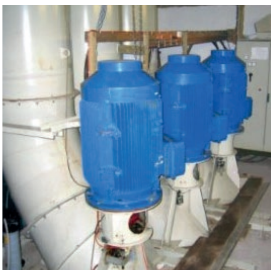
Vesivoimalan kolme 110 kW potkuriturbiinia. Kunkin potkurin halkaisija on 650 mm. Virtaama turbiinia kohden on 1,8 m³/s.
